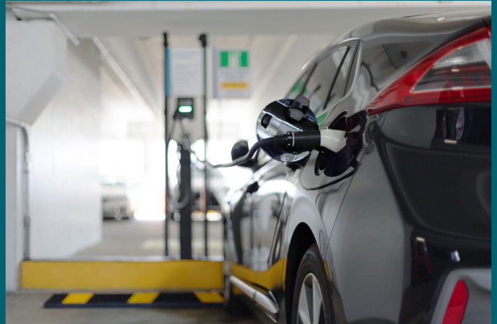
列治文医院的电动汽车充电站。
